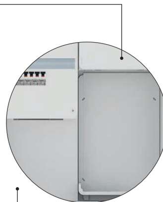
Bac Volume attendant VABL : 2 prises + emplacement pour coffret de communication.
